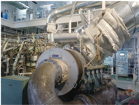
图 15 增压器试验平台
