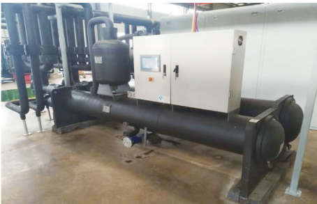
(a) 水源热泵机组
