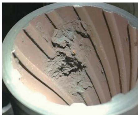
图6 水冷壁管垢下腐蚀
